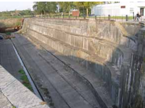
La forme Napoléon III à Rochefort. Le bateau-porte pétardé par les Allemands au printemps 1945 a favorisé l'envasement de l'ouvrage. Complètement dévasé il y a quelques années, c'est un point fort du site de l'arsenal-musée de Rochefort.
